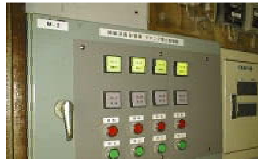
ピークシフト制御盤
