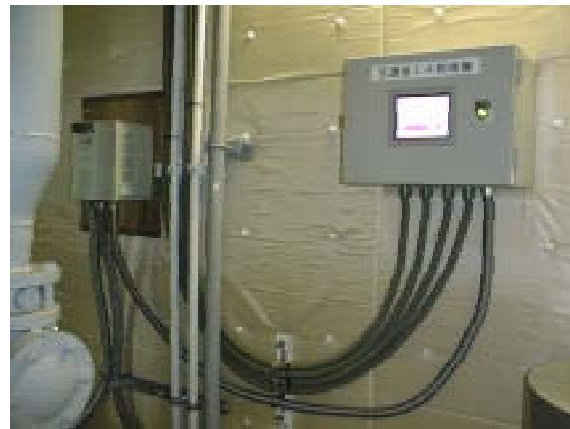
インバータと省エネ制御盤
