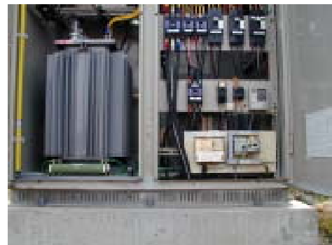
制限抵抗と簡易型デマンドコントローラを取り付けたキュービクル
