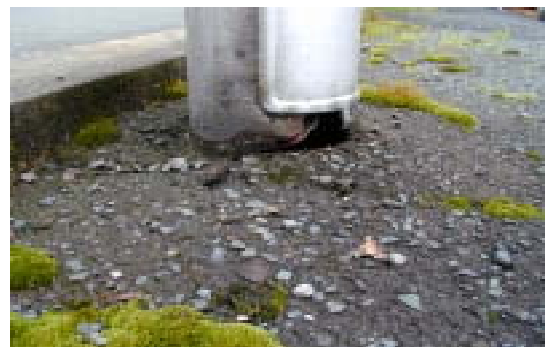
地際が甚だしく腐食した水銀灯ポール
