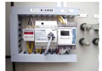
簡易型デマンド制御盤
